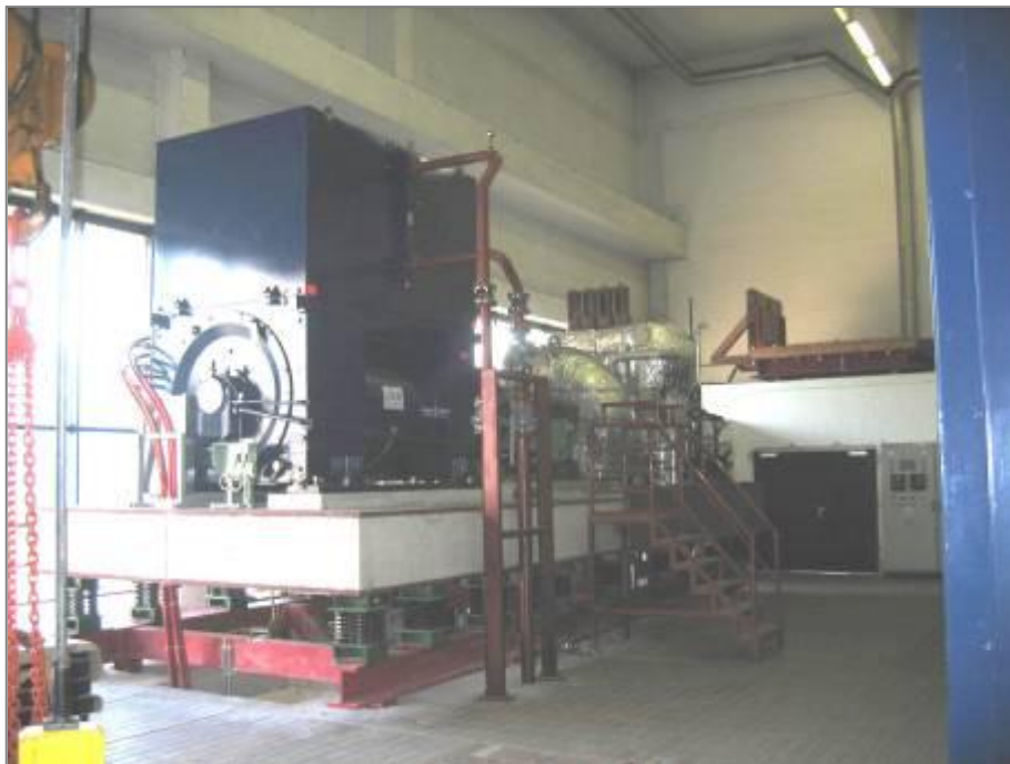
rys. 34: Turbina z generatorem na betonowej płycie z pakietami sprężynującymi..
