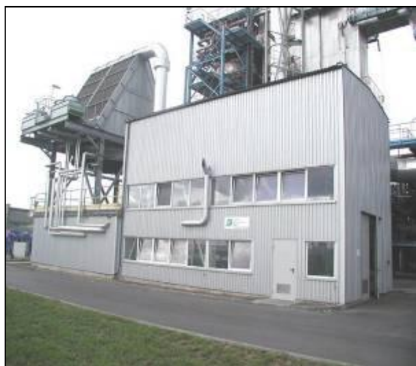
rys.36: Maszynownia z kondensatorem powietrznym,
