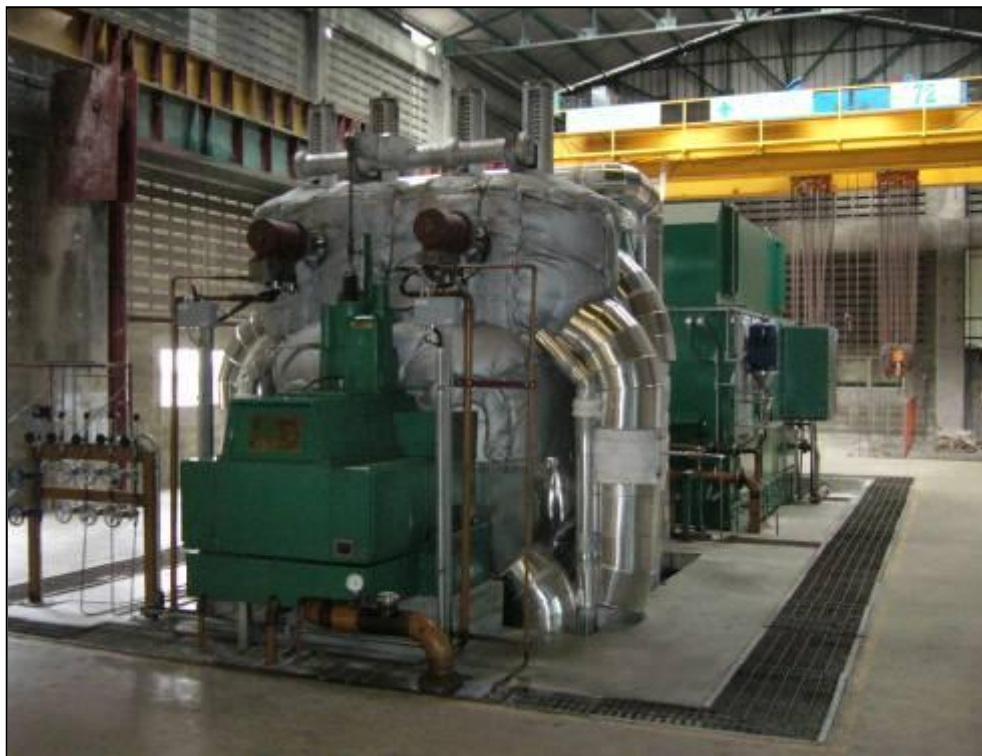
Rys. 33: widok na turbinę podczas pracy w pielni
